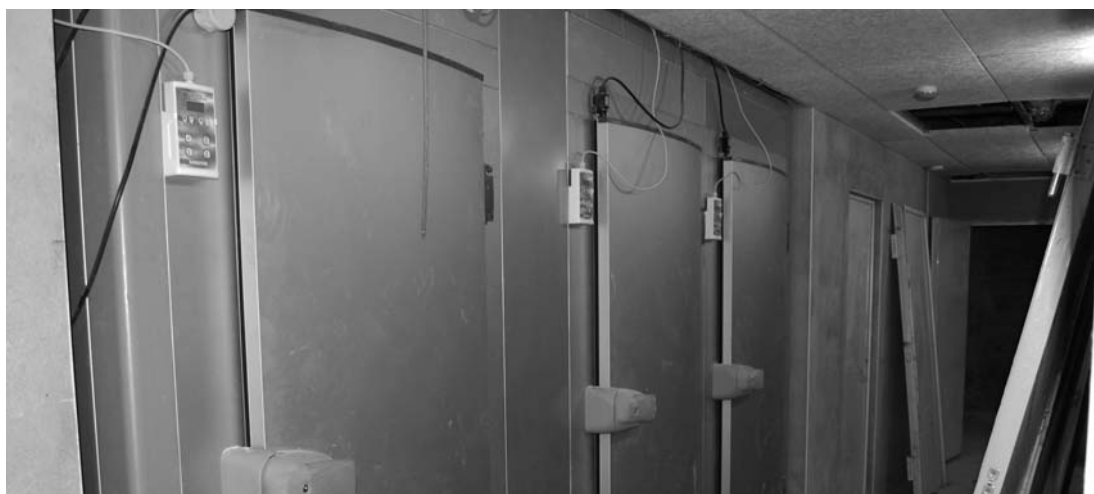
Càmares frigorífiques de la cuina al soterrani segon
